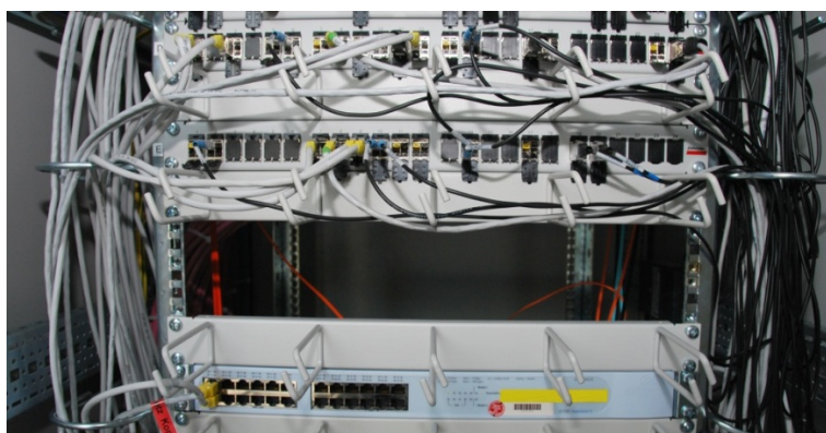
Abbildung 5 Verteilerschrank eines mittelgroßen Netzwerks mit 2 Verteilerfeldern (oben) und Netzwerkschicht (unten)
